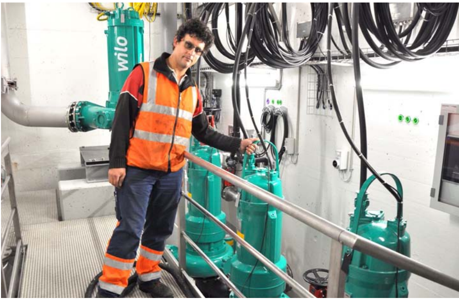
Alles im Griff: Der Brunnenmeister Marcello Cortesi im neuen Abwasserpumpwerk.
